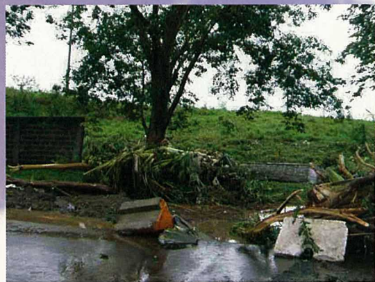
陥没した高速道路
